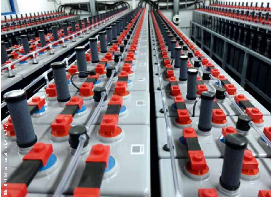
Bleibatterien sind noch lange nicht out. Im Großspeicher M5Bat in Aachen wird das Zusammenspiel von fünf unterschiedlichen Batteriesystemen auf Basis von Lithium-Ionen oder Blei untersucht. Der Großspeicher verfügt über sechs Stränge, in denen verschiedene Lithium-Ionen-Batterien eingesetzt sind, und vier Stränge mit Bleibatterien. Mit diesem modularen Aufbau erproben die Wissenschaftler das Zusammenspiel der verschiedenen Batteriesysteme.
