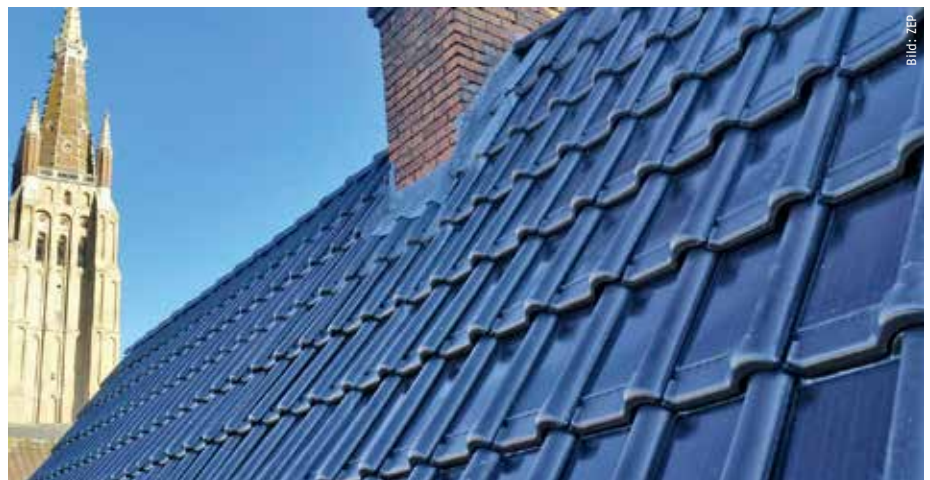
Frappierend, dass sich die Solardachziegel auf den ersten Blick nicht von herkömmlichen Tondachziegeln unterscheiden. Der Blick ist der auf ein „gewöhnliches“ Dach.
